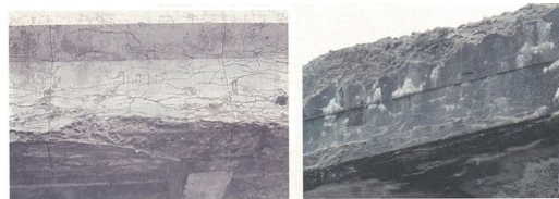
例2) スケーリング・長手方向ひび割れ 長手方向を主とした微細ひび割れ 表層部のスケーリング
