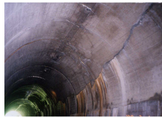
アーチ肩部の開口ひび割れ （トンネル軸方向）
