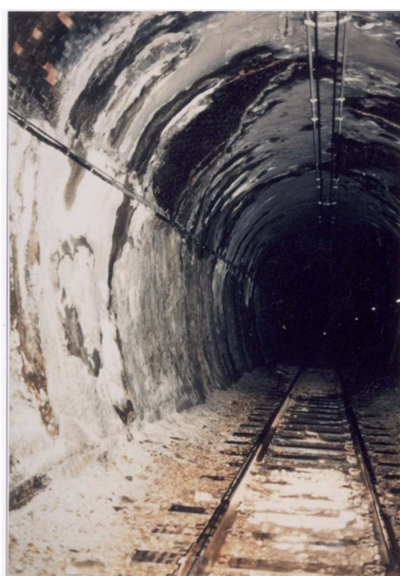
煉瓦トンネルにおける 吹付けモルタルの剥落
