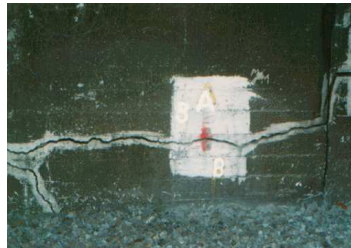
側壁部の開口ひび割れ （トンネル軸方向）
