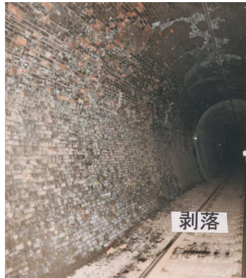
煉瓦表層の剥落
