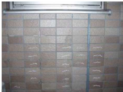
打音調査にて剥離タイル にマーキングした状況
